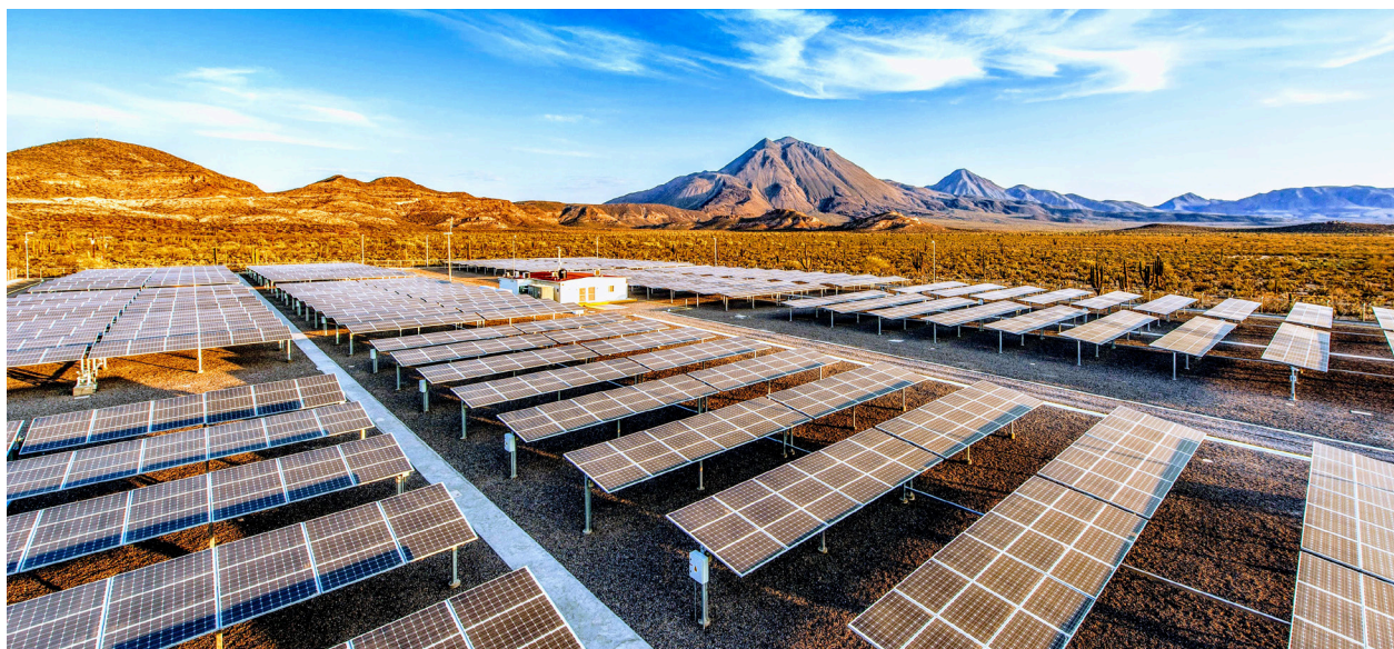
Central fotovoltaica, Santa Rosalía, Baja California Sur. Comisión Federal de Electricidad.
