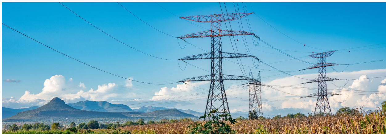
Torres de transmisión , Tula, Hidalgo Comisión Federal de Electricidad
