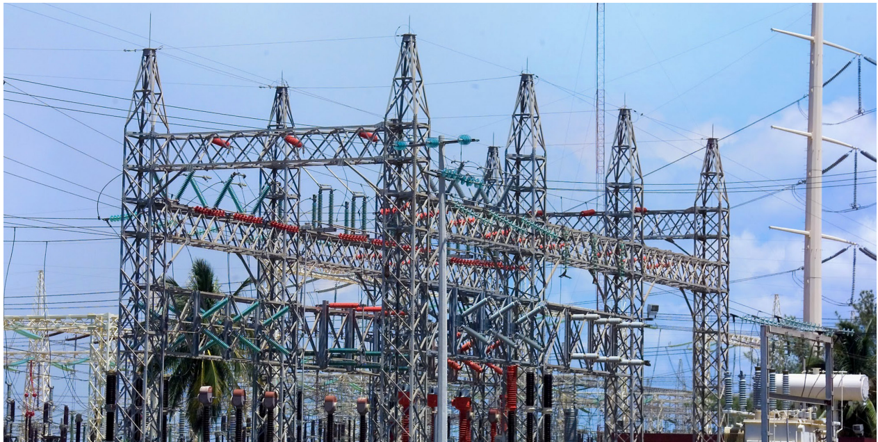
Subestación eléctrica, Tuxpan, Veracruz Comisión Federal de Electricidad
