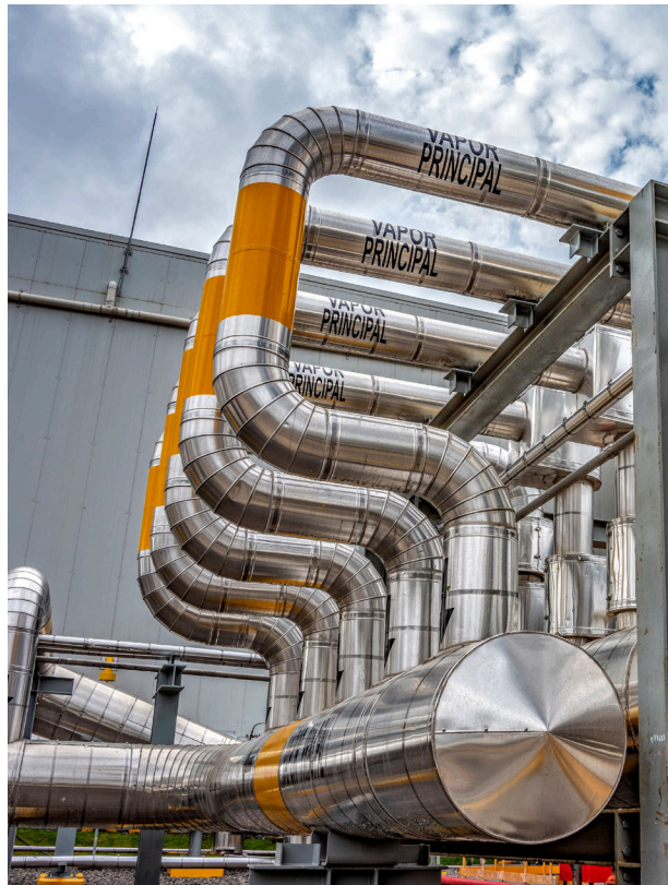
Central geotérmica, Sierra de San Andrés, Michoacán. Comisión Federal de Electricidad.
