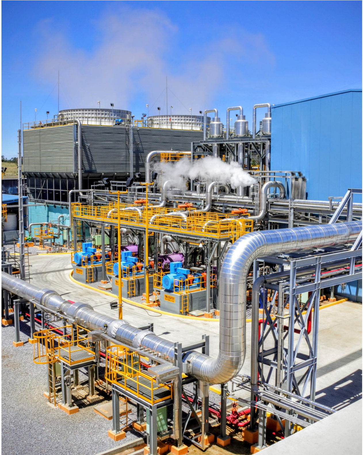
Central geotermoelectrica, Chignautla, Puebla. Comisión Federal de Electricidad.
