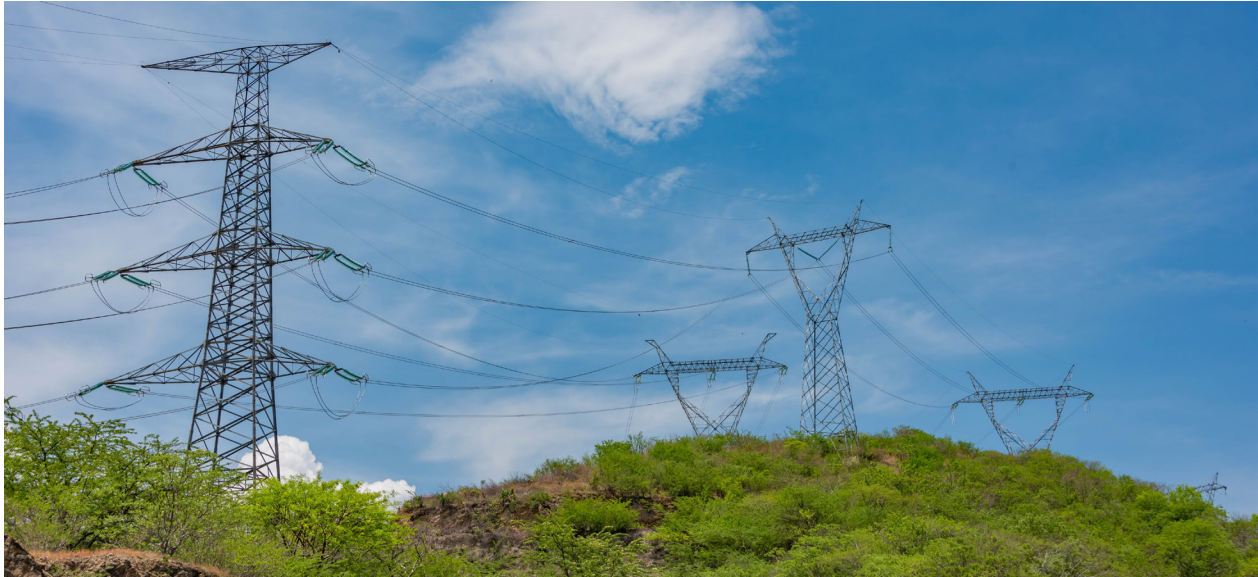
Torres de transmisión , Heliodoro Castillo, Guerrero. Comisión Federal de Electricidad.
