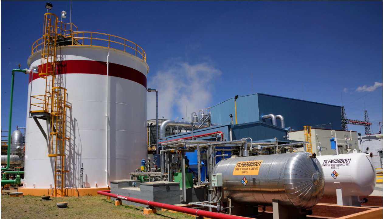
Central geotérmica, Chignautla, Puebla Comisión Federal de Electricidad.
