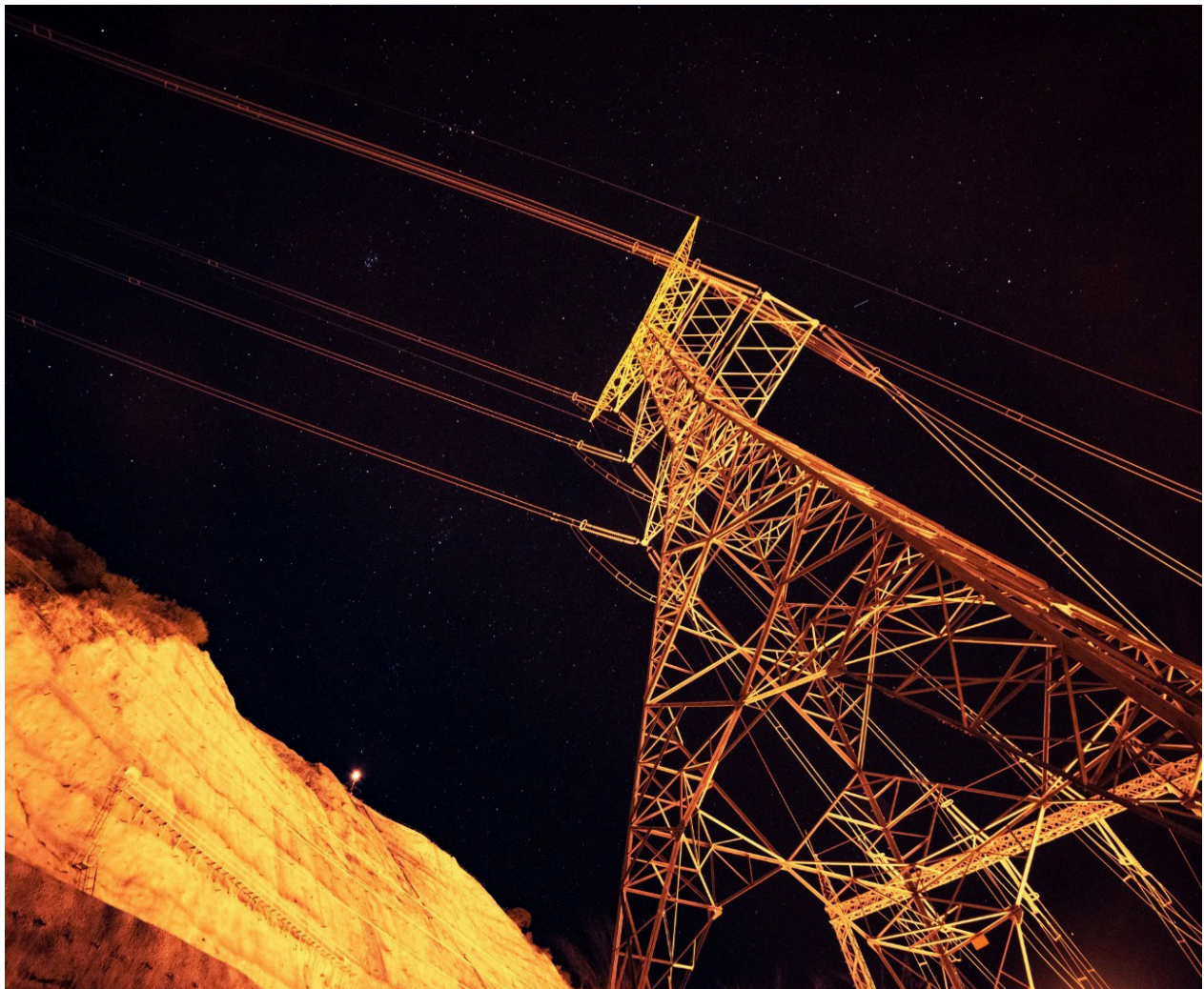
Estructura autoportada, subestación de la central hidroeléctrica. La Yesca, Nayarit. Comisión Federal de Electricidad.
